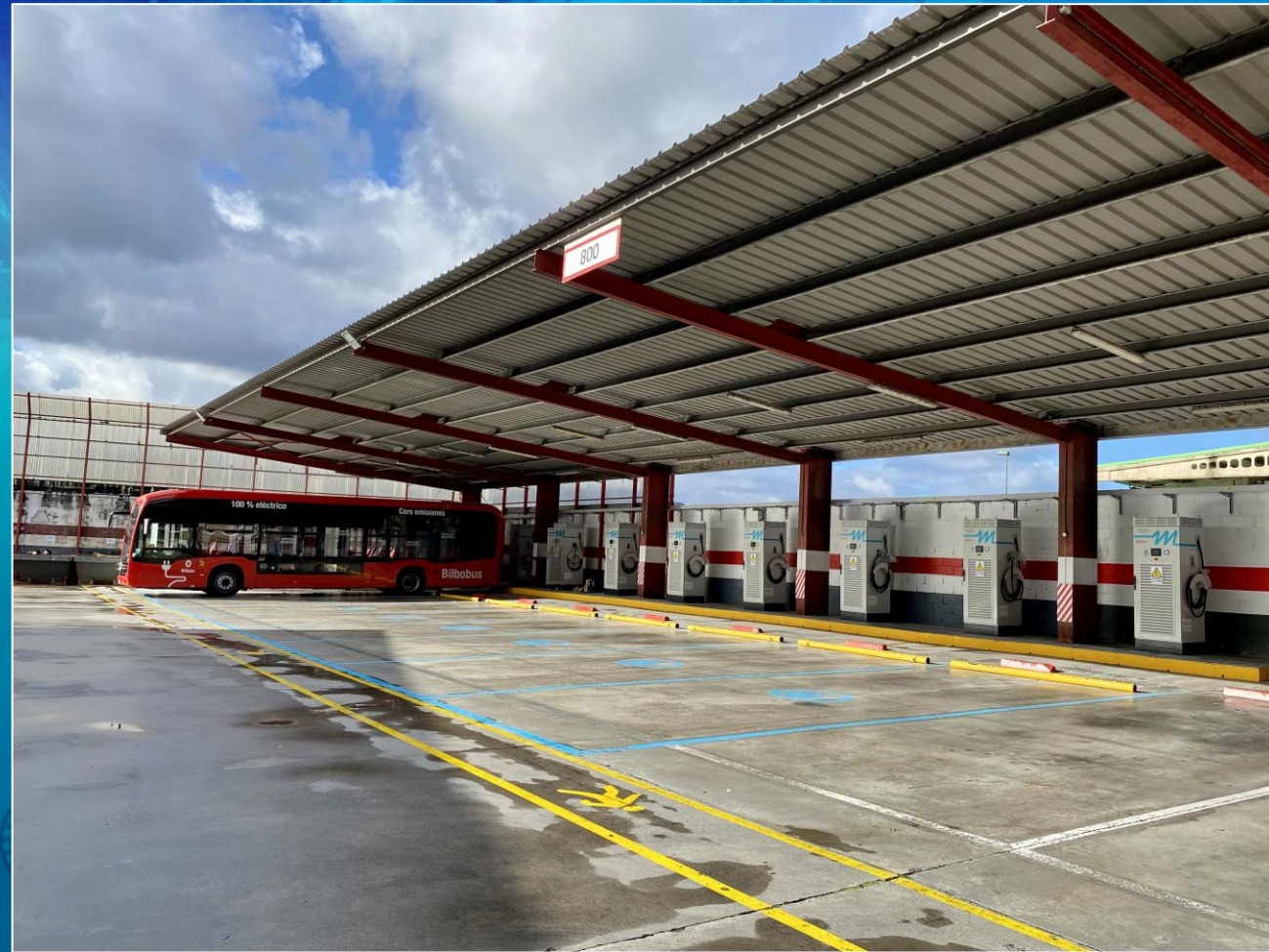
Instalación interior en cocheras de Bilbobus
